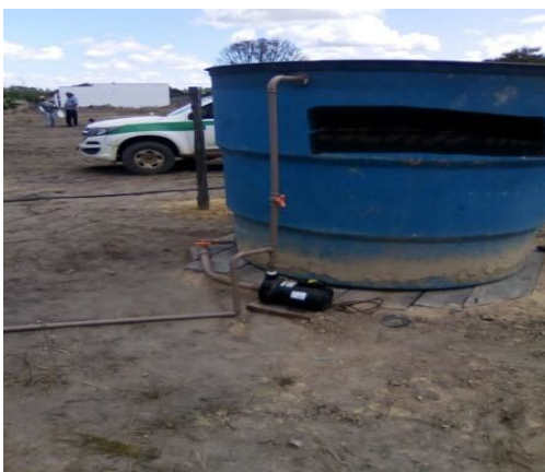
Foto 28: Caixa e bomba d'água para irrigação
